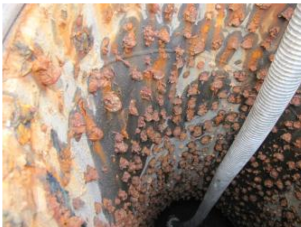
شکل ۳- سیستم لوله آتش نشانی که تحت تاول زدگی شدید قرار گرفتند [۵]
