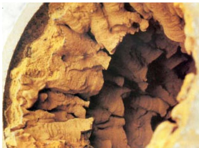
شکل ۱۵- تاولهای رشد یافته در جهت جریان سیال در یک خط لوله آب [۶]
